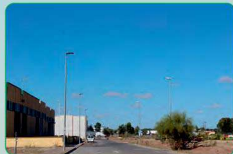
Nuevo alumbrado LED municipal
