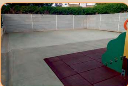
Colocación de valla perimetral y hormigonado del patio de infantil CEIP Ana Josefa Mateos
